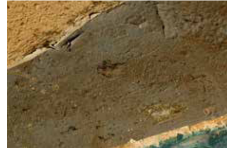
5. Suciedad y concrecciones.
