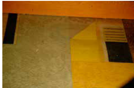
4. Manchas de humedad y alteraciones de pigmento.
